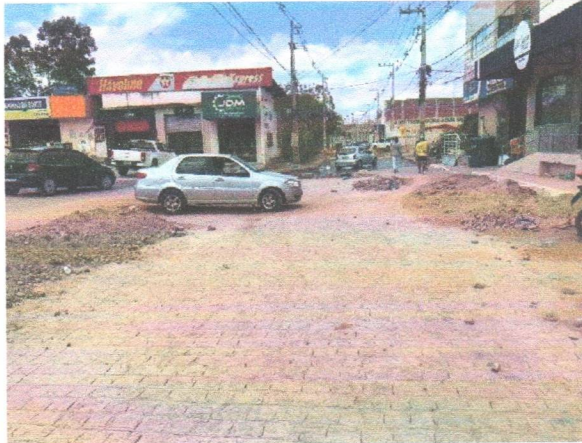
FOTO 04: RUA DA SUBESTAÇÃO;
