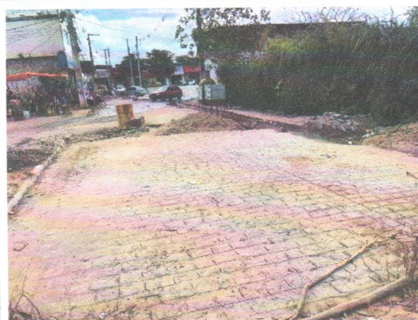
FOTO 05: RUA DA SUBESTAÇÃO;
