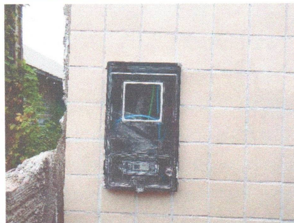
FOTO 15: Quadro de Medição;
