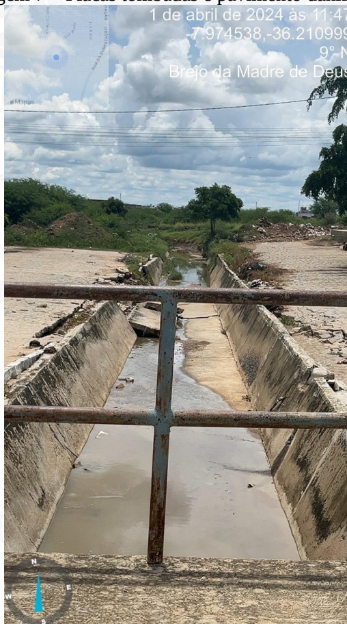
Imagem 7 – Placas tombadas e pavimento danificado
