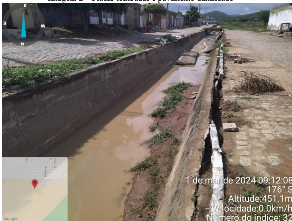
Imagem 2 – Placas tombadas e pavimento danificado
