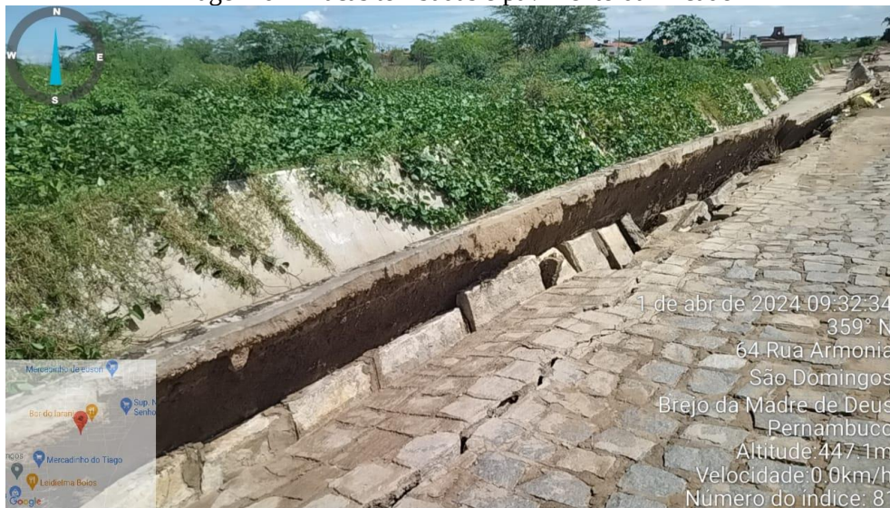
Imagem 6 – Placas tombadas e pavimento danificado
