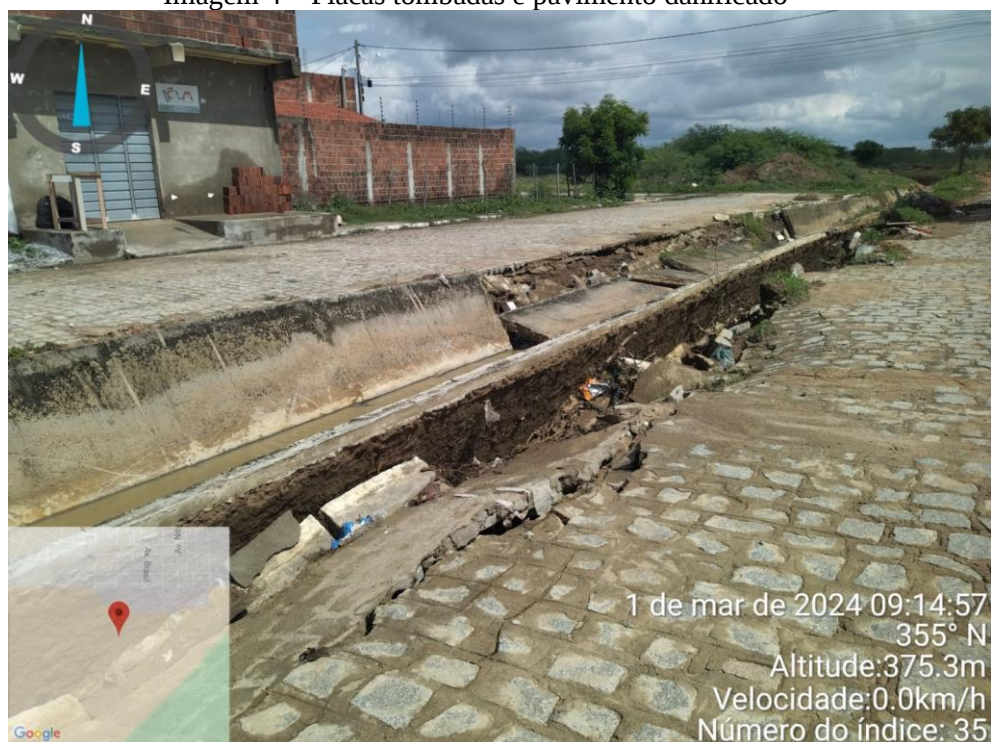
Imagem 4 – Placas tombadas e pavimento danificado
