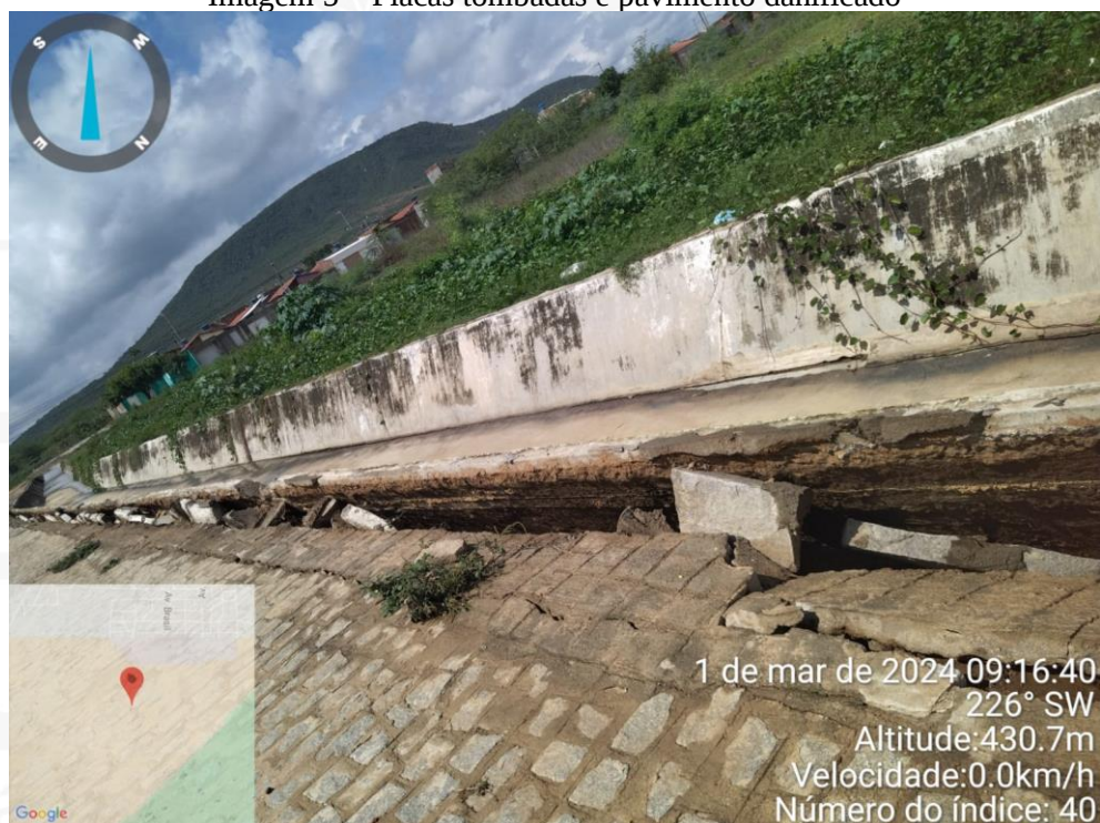
Imagem 5 – Placas tombadas e pavimento danificado
